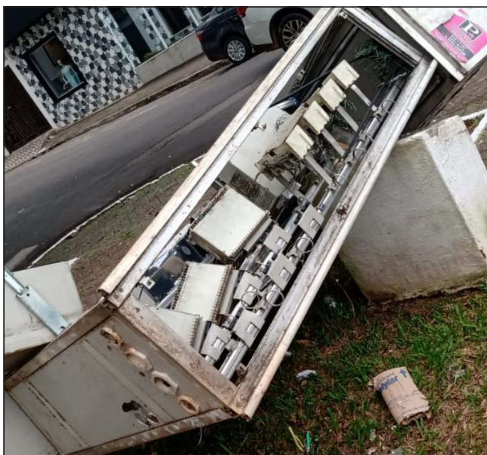
Armário de telecomunicações arrancado da base e jogado na praça Gabriel Ferreira no bairro Nova Pouso Alegre
